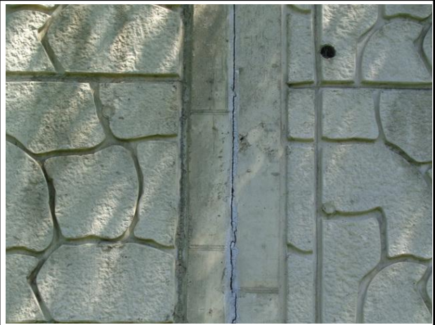
S1 실란트 파손
