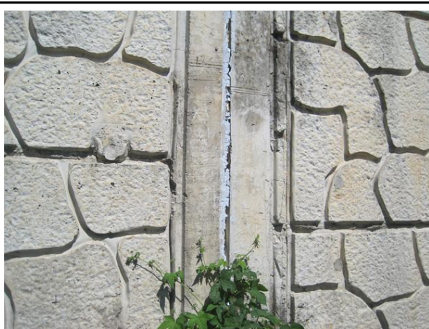
S10 실란트 파손
